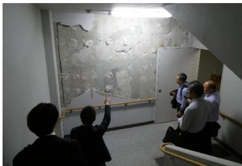
能登半島地震によって崩れた壁面
